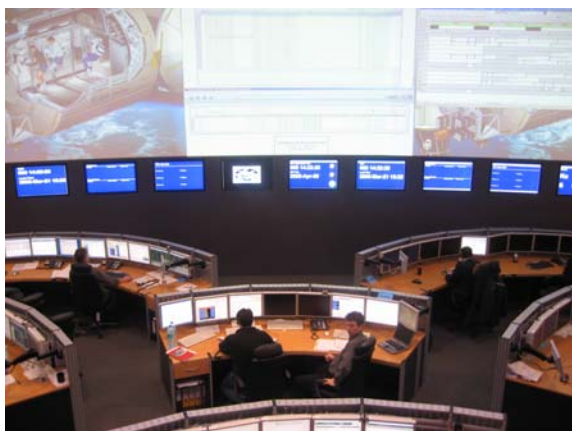
Kontrollzentrum in Oberpfaffenhofen
